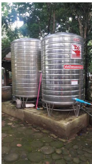
ถังเก็บน้ำบาดาล
