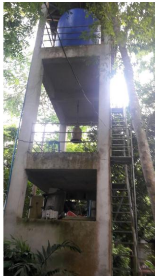
หอรบั้งและแท่งก้นน้ำประปา
